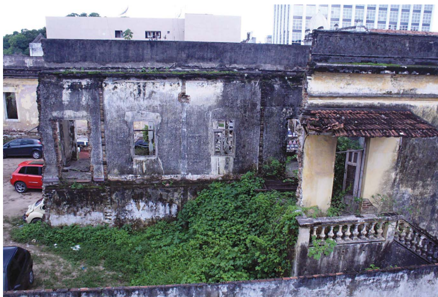
As paredes dos casarões rachadas e com infiltrações colocam em risco a vida das pessoas
