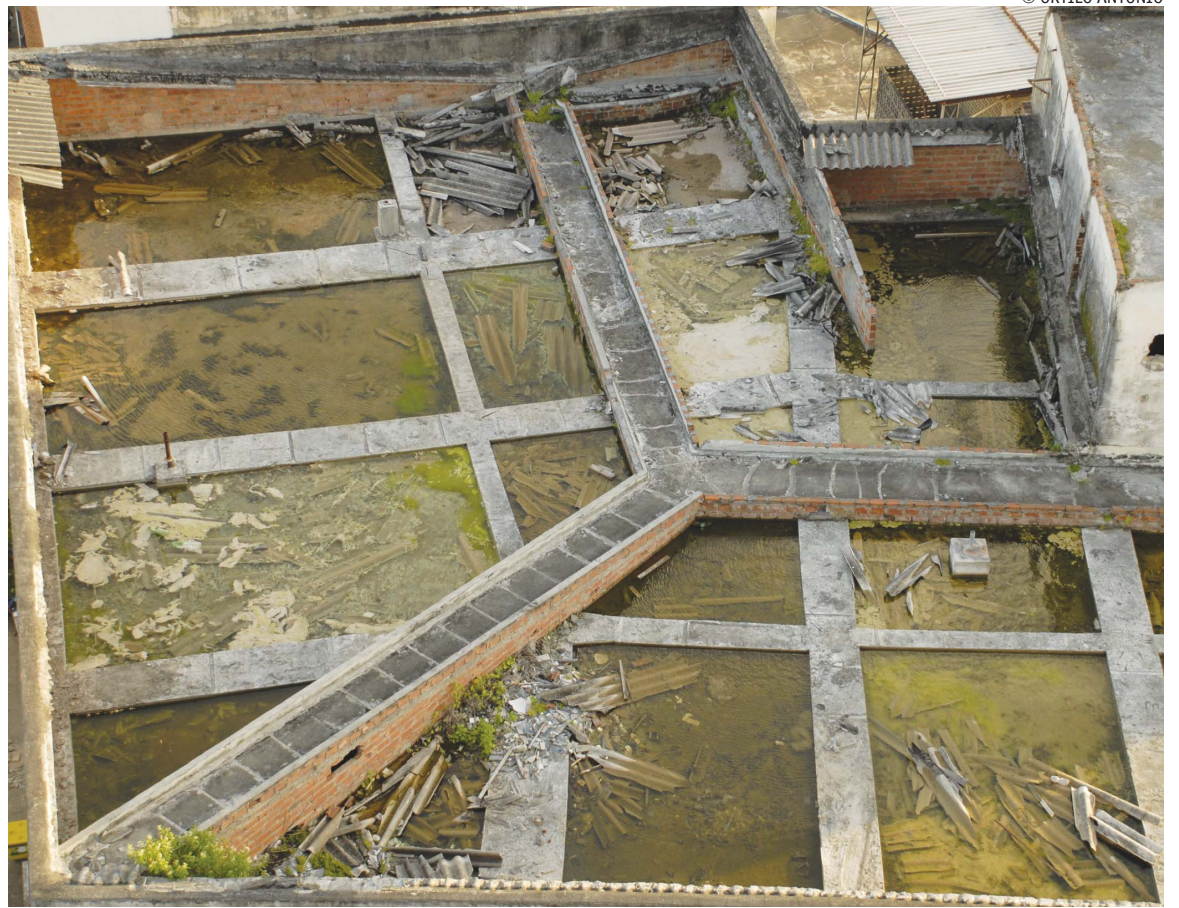
Piscinas cheias d'águas do prédio recebem a visita periódica de fiscais da vigilância da Prefeitura Municipal
