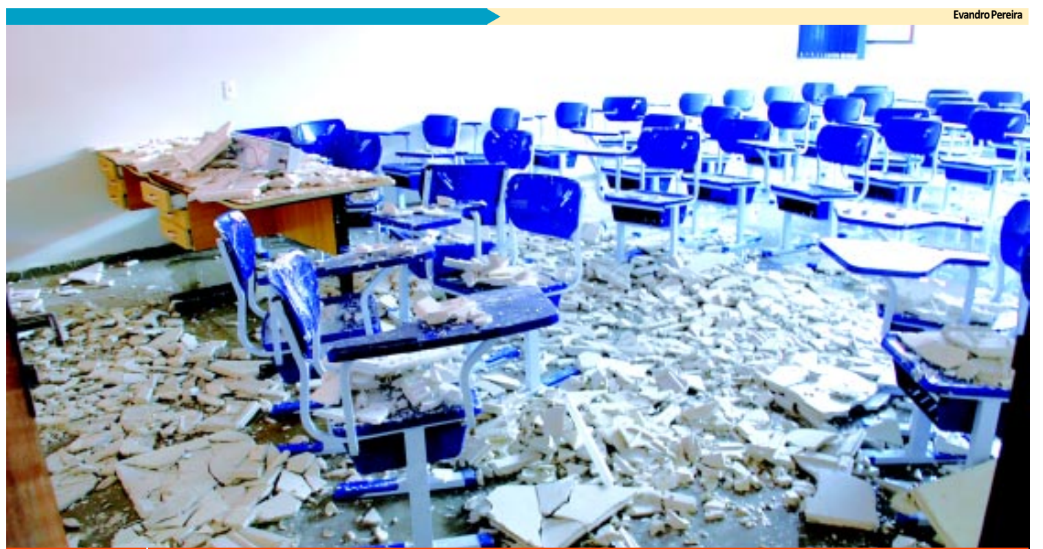
NA UFPB Obras entregues há 4 meses já estão danificadas por infiltrações PÁGINA 9
