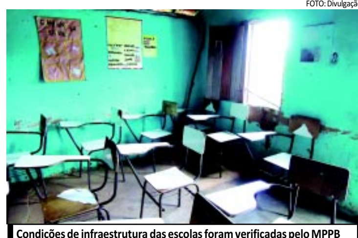
Condições de infraestrutura das escolas foram verificadas pelo MPPB
