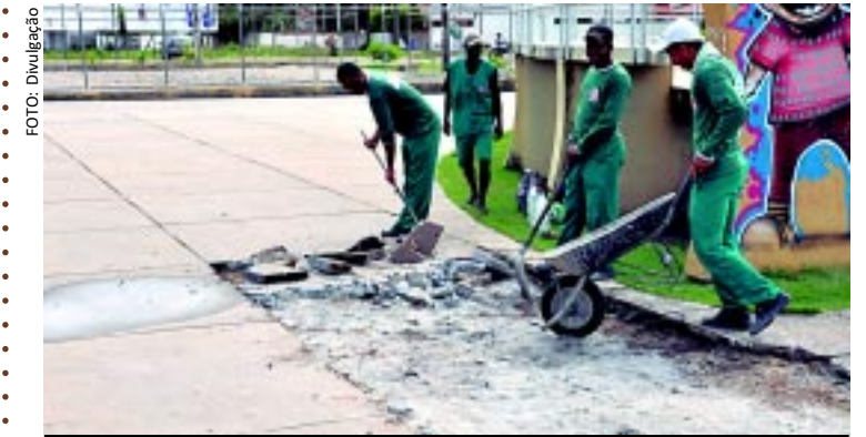
[FOTO&LEGENDA] O trabalho de recuperação da Praça do Caju, no bairro do Bessa, foi iniciado esta semana pela equipe de manutenção da Secretaria de Desenvolvimento Urbano (Seburd). O local necessita de reparos na área dos brinquedos e no passeio.
