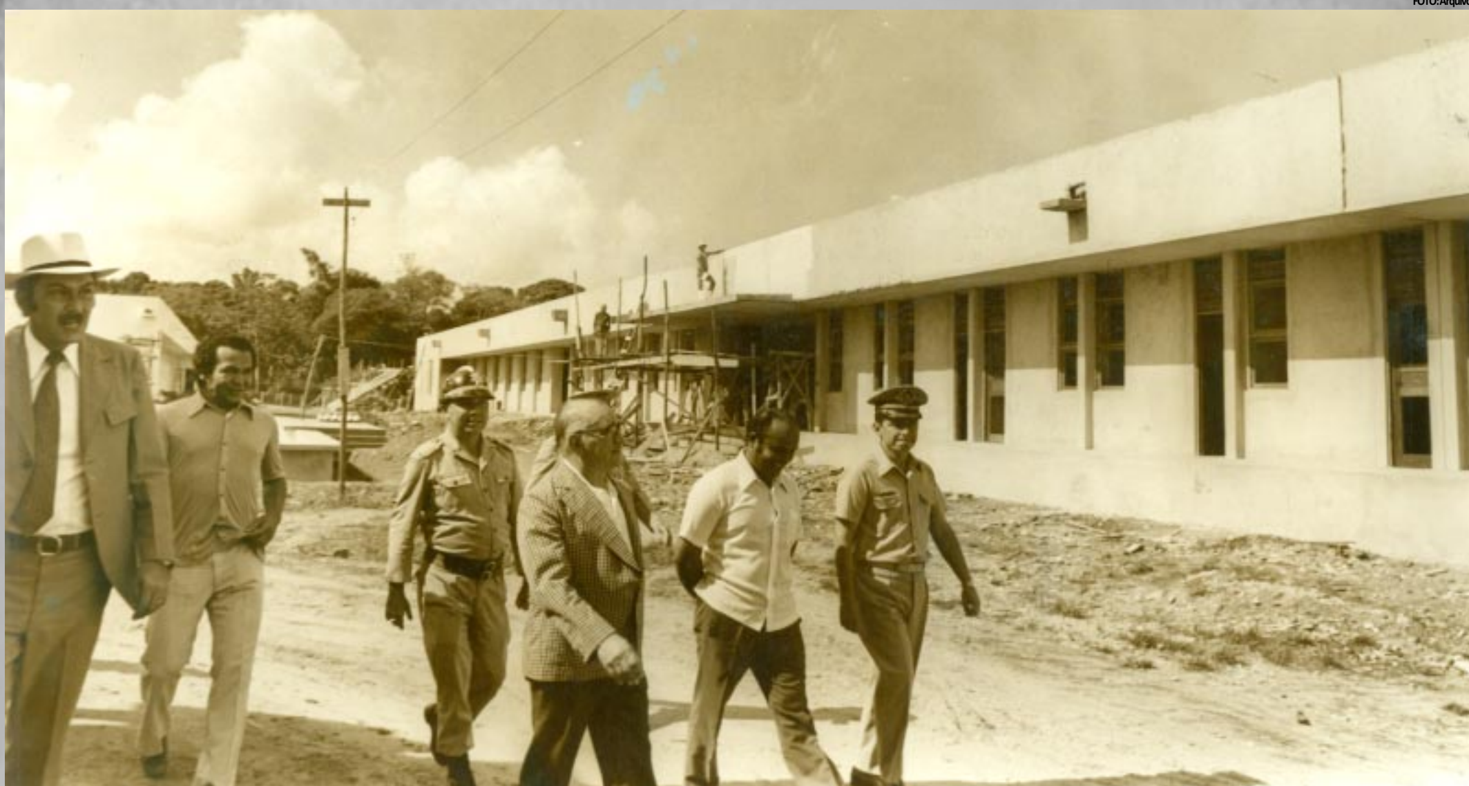
Sátiro fazia visitas às obras para ver de perto o trabalho executado; na foto o ex-governador vistoria a construção do prédio do Corpo de Bombeiros
