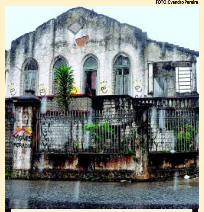
Com a continuidade das chuvas, os prédios podem desmoronar
