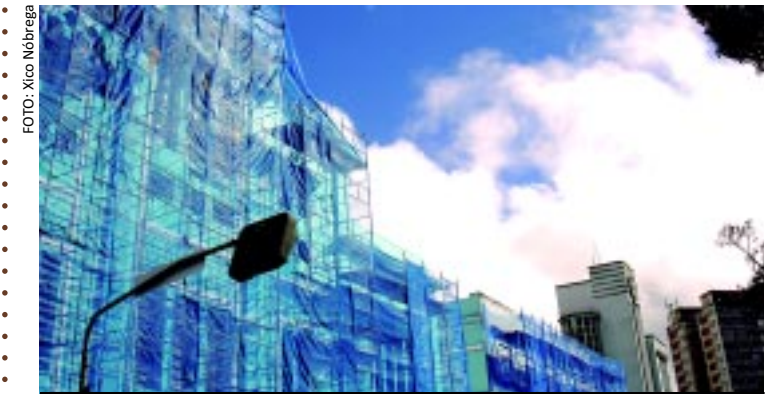
FOTO: Xico Nóbrega O prédio do Colégio das Damas de Campina Grande exibe os tapumes telados azuis para proteger o pedestre. Tudo a ver com o céu azul e ensolarado na Serra da Borborema deste início de semana, depois os últimos dias nublados e chuvosos. A obra de pintura é vistoriada pelo Iphaep.
