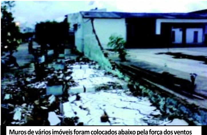
Muros de vários imóveis foram colocados abaixo pela força dos ventos
