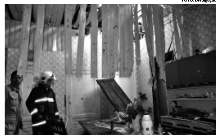
Fogo começou em um dos cômodos e destruiu cama e colchões
