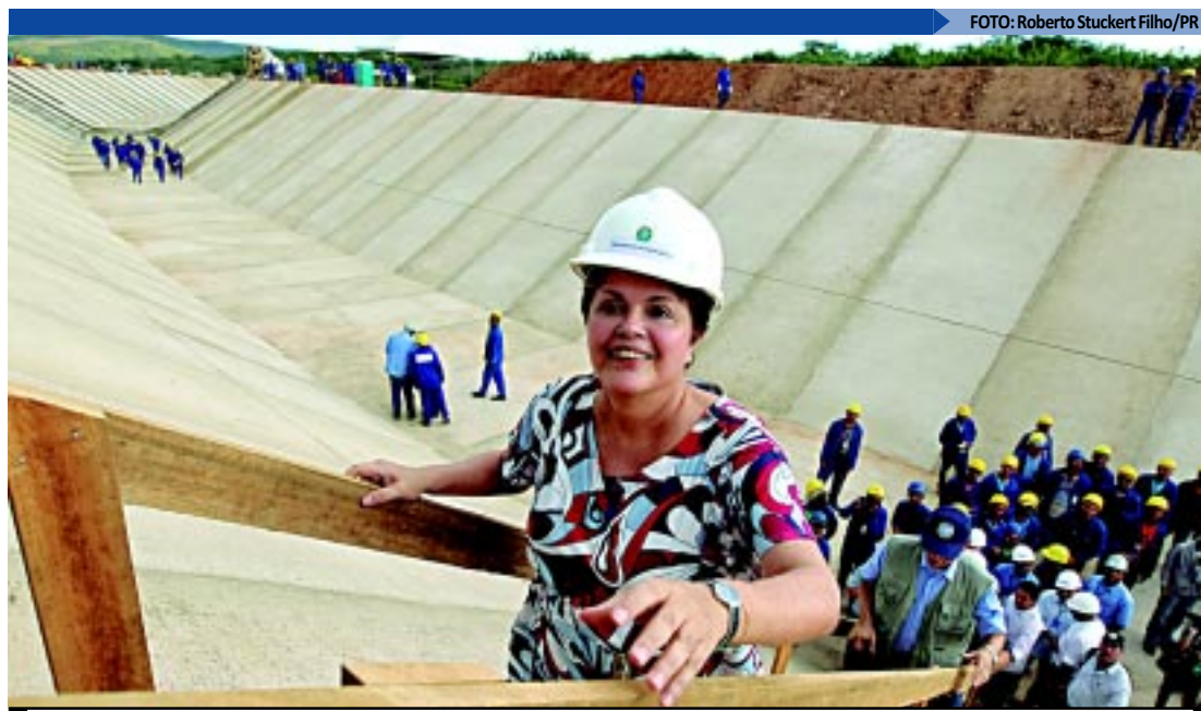
Dilma visitou os trechos das obras nas cidades de Juazeiro do Norte, no Ceará, e em Floresta, Pernambuco
