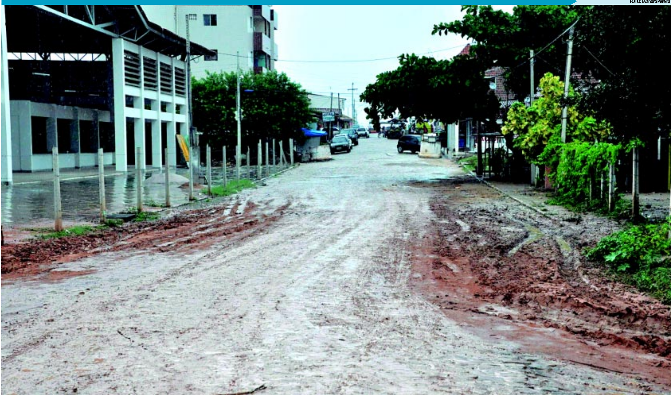
Ruas esburacadas e com acúmulo de lama se tornou cena comum em Jacumã cujo asfalto da via principal se acha precário em muitos trechos; lixo jogado em terreno baldio também atormenta os moradores e visitantes
