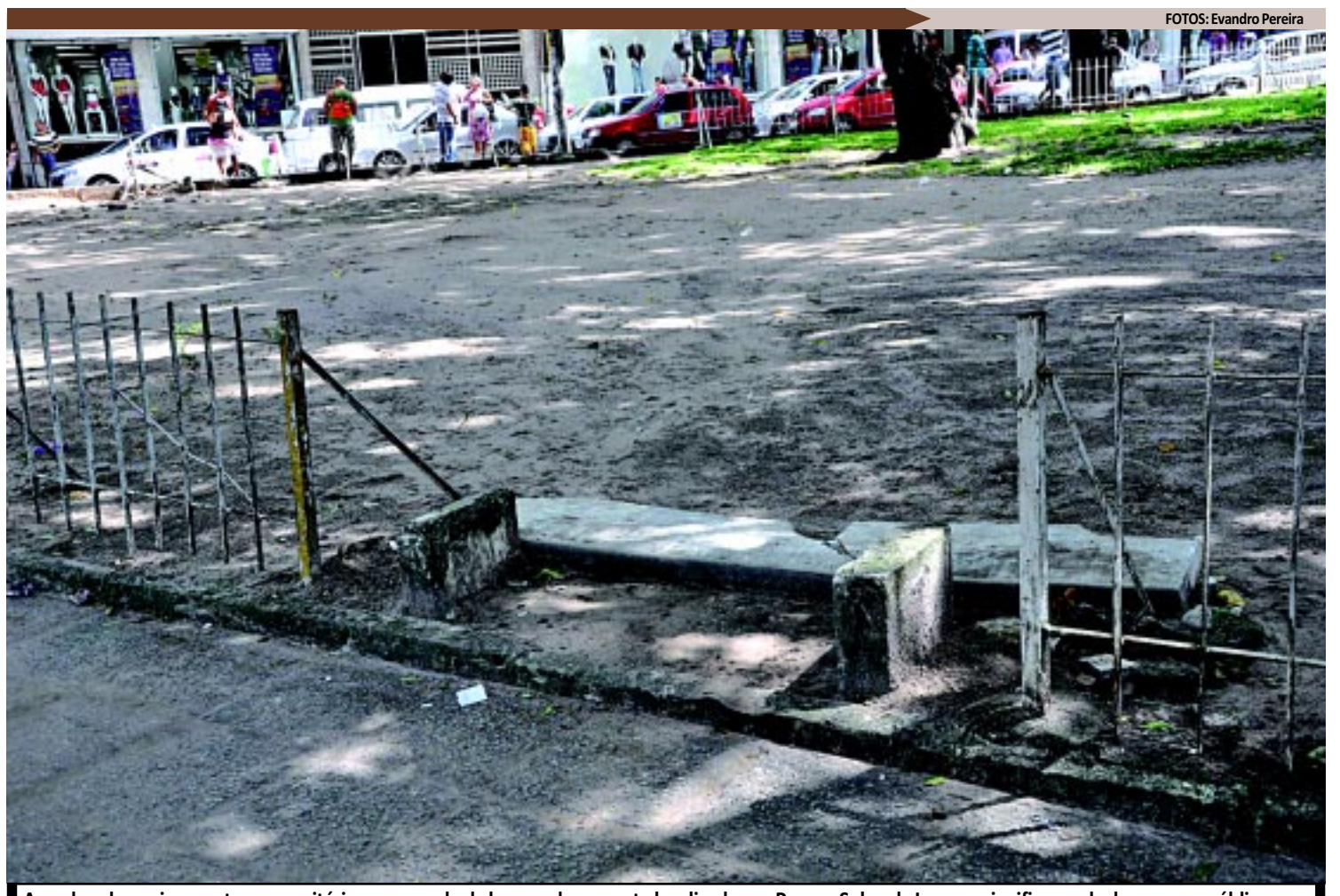
A quebra de equipamentos comunitários, a exemplo de bancos de concreto localizados no Parque Solon de Lucena, significa perda de recursos públicos
