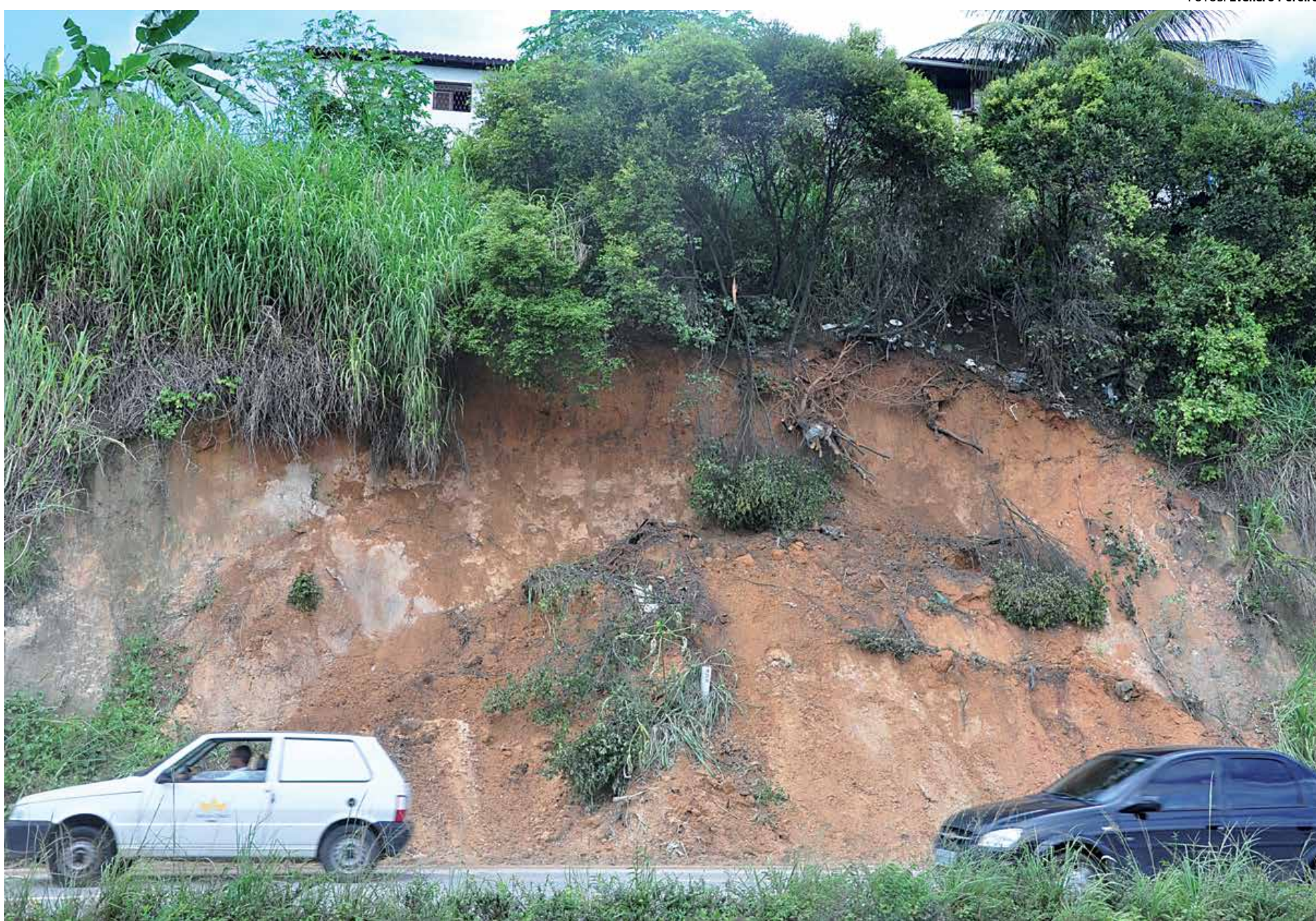
As chuvas registradas em João Pessoa provocaram desabamento de barreiras, como a localizada às margens da BR-230, na Comunidade Santa Clara, no Castelo Branco
