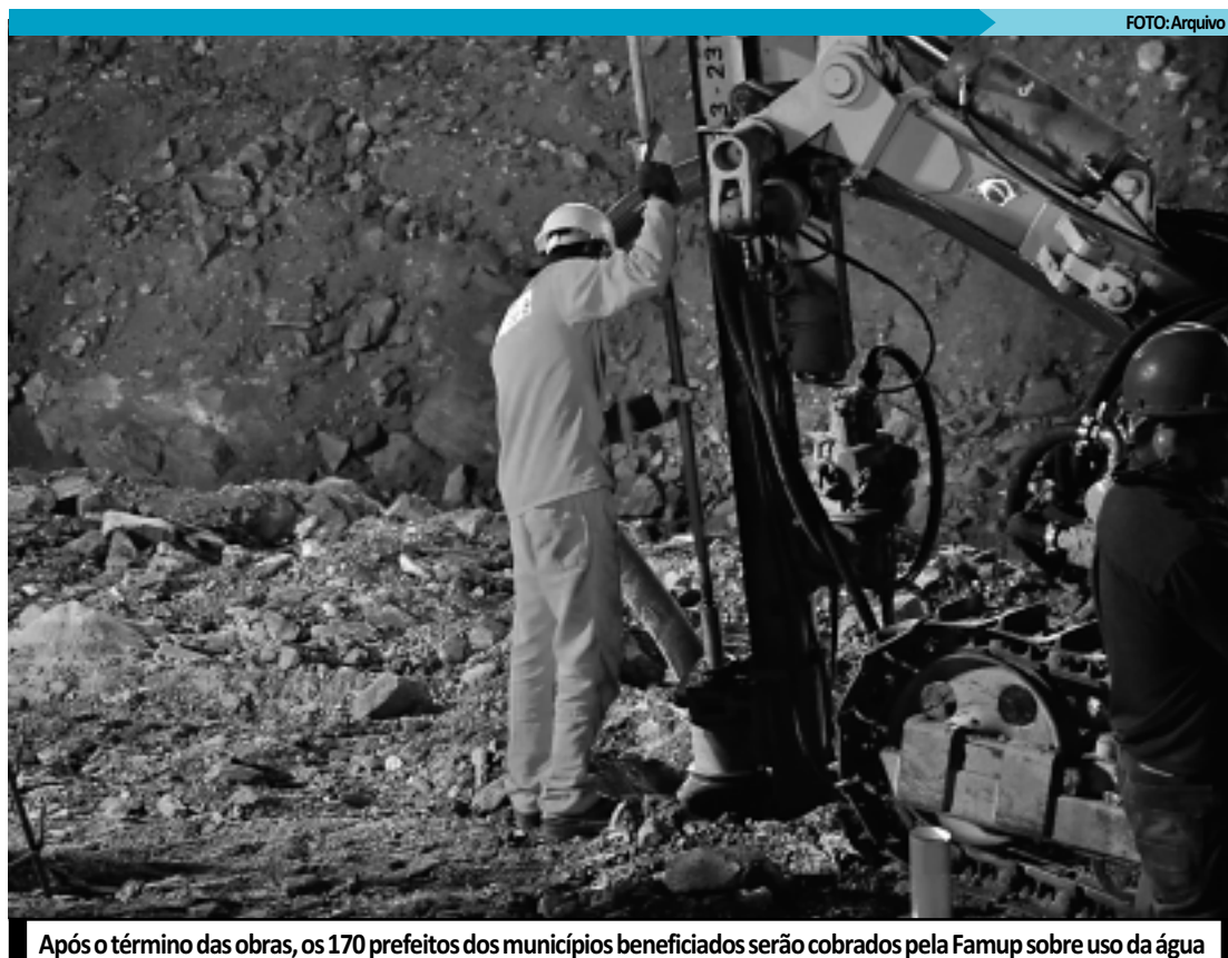
Após o término das obras, os 170 prefeitos dos municípios beneficiados serão cobrados pela Famup sobre uso da água
