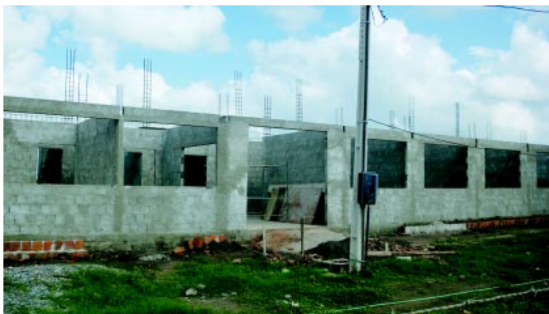
Obras estão em ritmo acelerado para a entrega do novo prédio da Unidade de Saúde da Família no Bairro Vermelho
