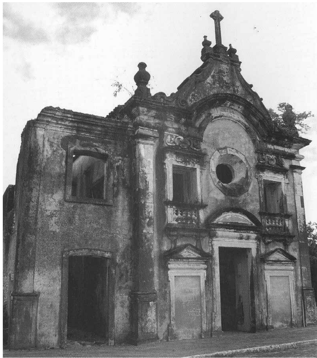
Acima, a Capela da Graça, dentro das terras onde também funcionou o engenho homônimo, antes da restauração. No alto, o conjunto arquitetônico totalmente recuperado
