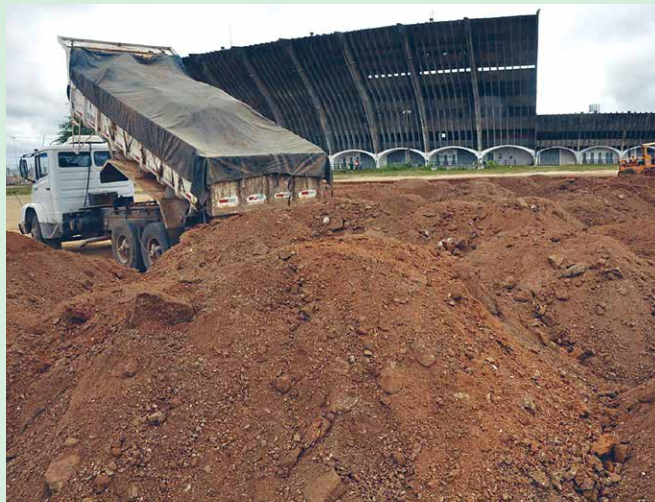
Serviço de terraplanagem já está sendo feito na área externa que vai ganhar urbanização e equipamentos esportivos
