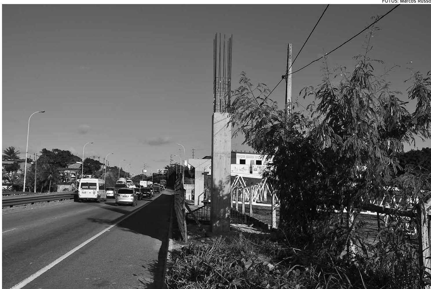
A passarela metálica está sendo construída nas proximidades do Makro e terá 235 metros, garantindo mais segurança à população
