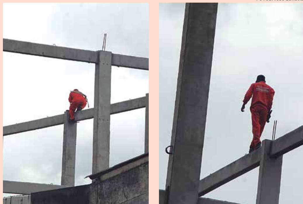
Um trabalhador, sem proteção, se equilibra ontem em vigas de concreto a 15 metros de altura
