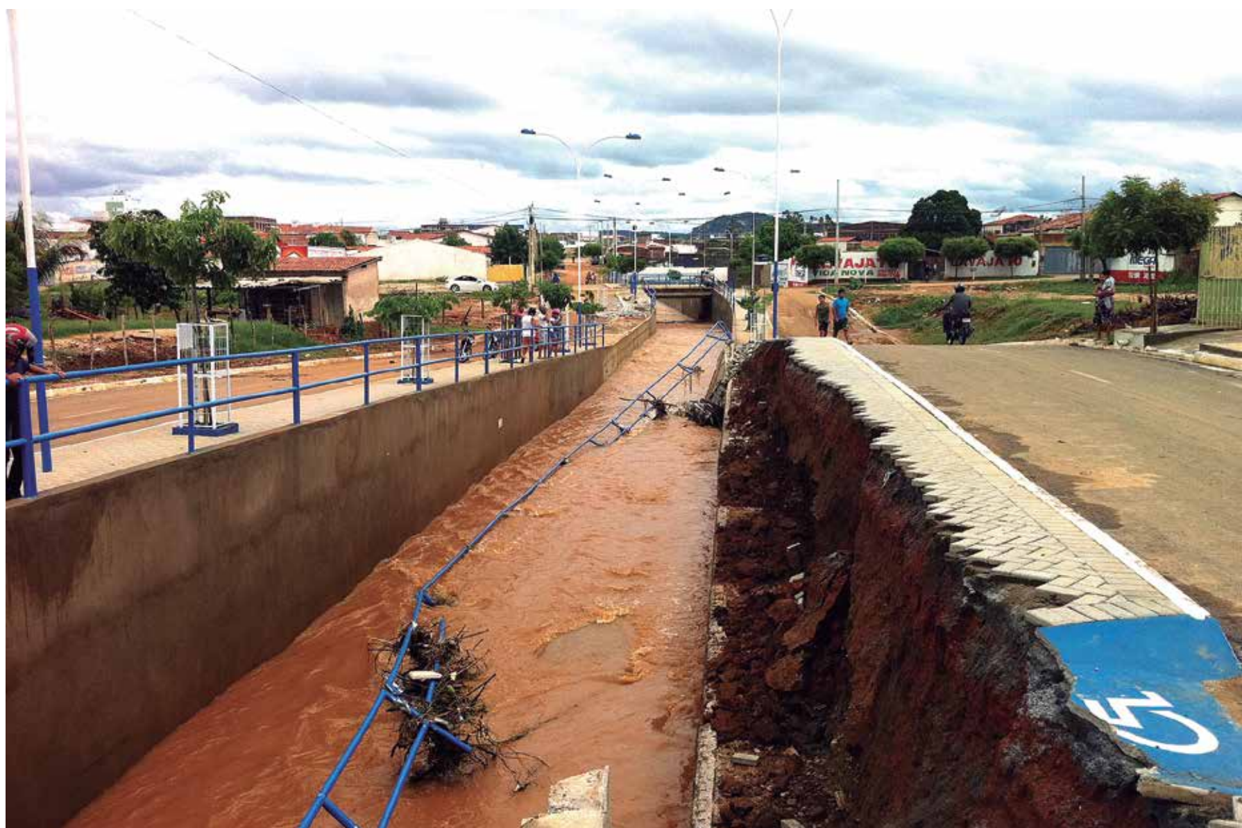
No dia de São José choveu forte no Sertão; em Patos, a força da água destruiu parte do Canal do Frango PÁGINA 14
