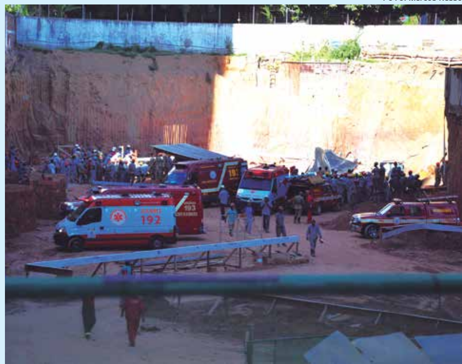
O resgate das vítimas que ficaram soterradas foi feito pelo Corpo de Bombeiros
