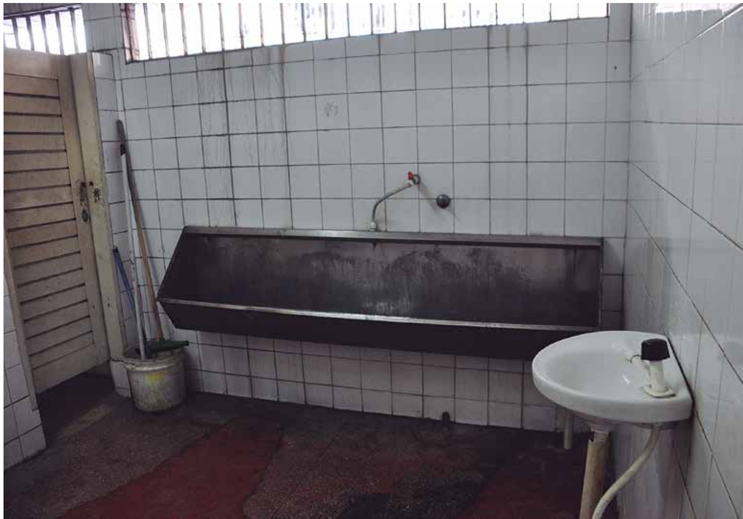
Nos banheiros do Viaduto Damásio Franca, no Centro, a má conservação é visível: sujeira por todos os lados, rachaduras e infiltrações
