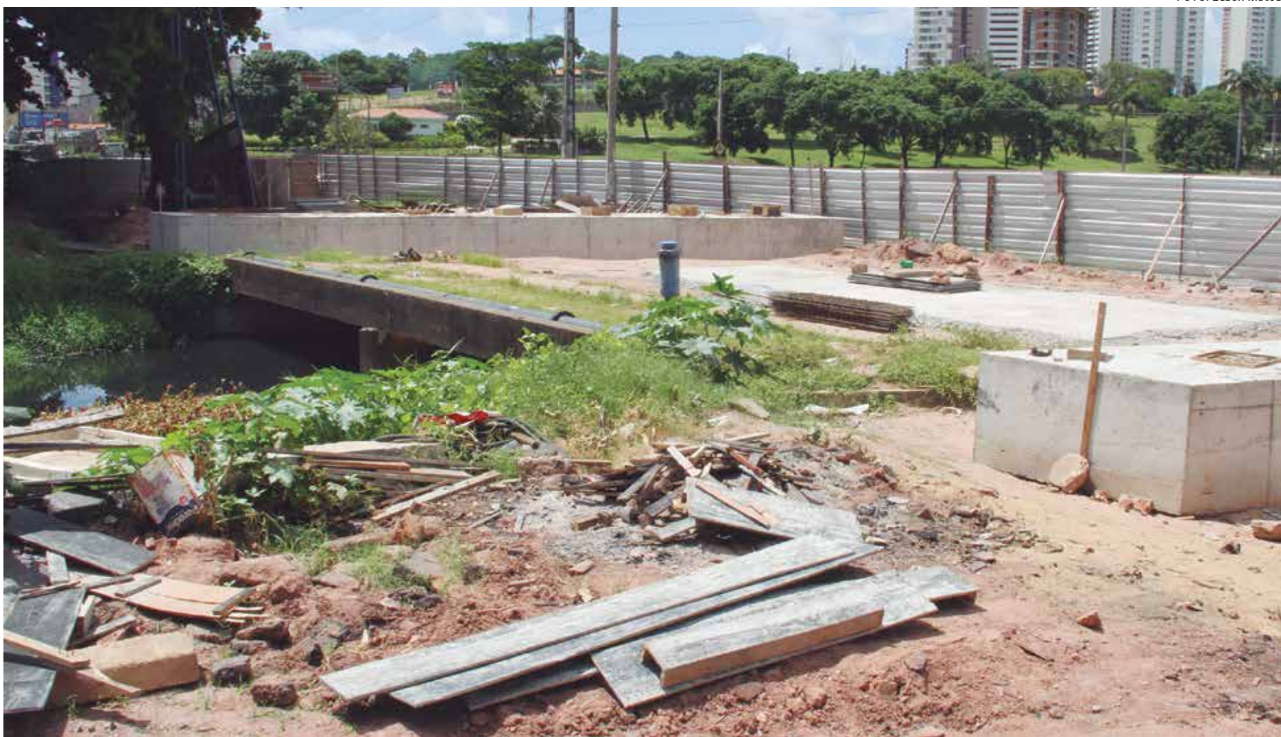
A obra de construção da ponte, que invadiu parte da Avenida Beira Rio, reduzindo a área de tráfego, ficou parada por muito tempo, de acordo com moradores
