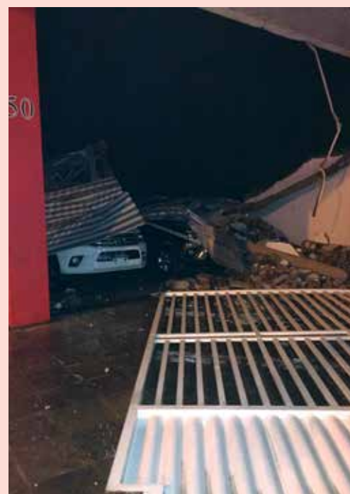
Ventos derrubaram teto de loja de veículos
