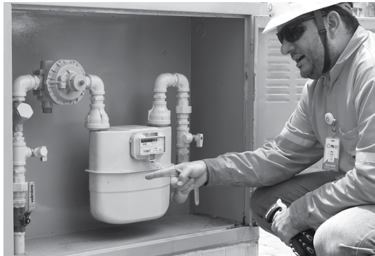
Rede de distribuição tem uma extensão de 308km, sendo 174,6km de rede na Grande João Pessoa
