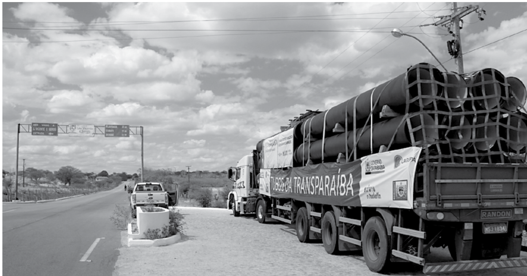
A TransParaíba também terá uma estação de tratamento e 21 estações de bombeamento e o sistema captará a água do Açude Boqueirão para abastecer 19 cidades
