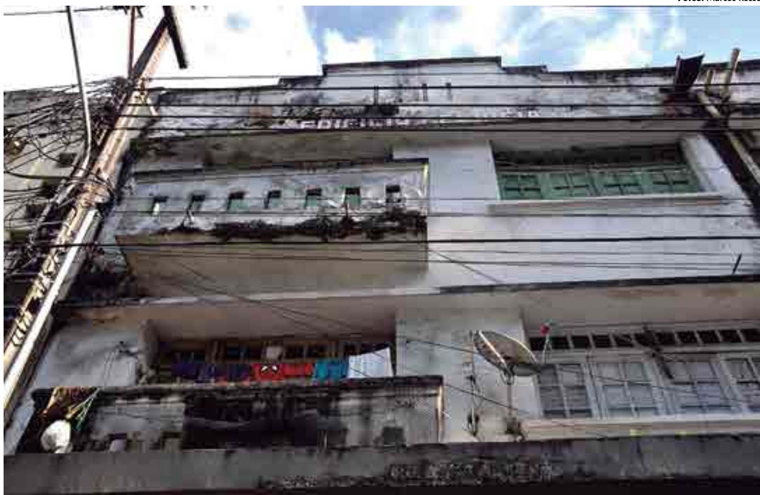
Para os mais atentos, é fácil encontrar fachadas de prédios no Centro da capital com sujeira, rachaduras e reboco caindo, expondo a estrutura de ferro
