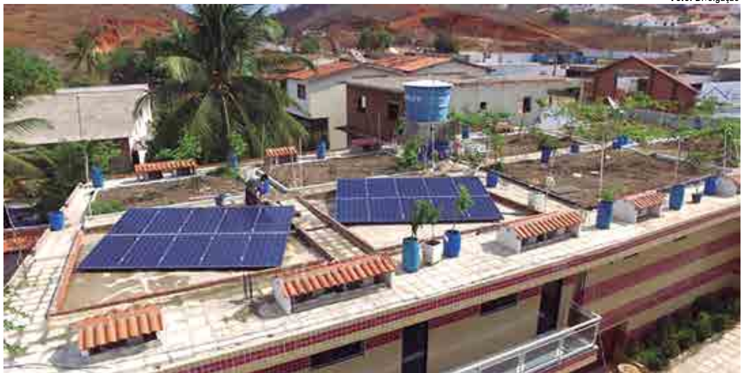
Na Pousada do Pandeiro, em Alagoa Grande, foram instaladas várias placas fotovoltaicas no telhado, convertendo os raios solares em eletricidade
