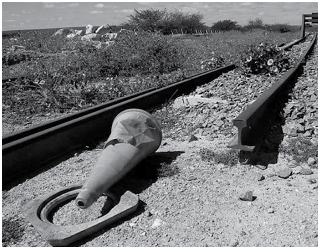
Obra está totalmente parada desde 2017 por causa de irregularidades apontadas pelo Tribunal de Contas da União
