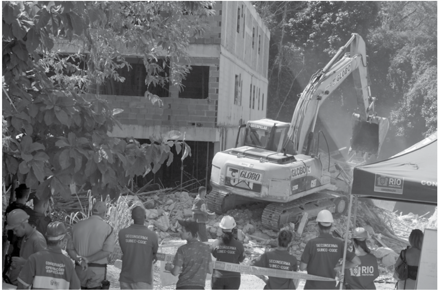
Durante vários dias, foram realizados trabalhos de resgates das vítimas. Responsáveis pelas construções estão com prisão decretada, mas fugiram
