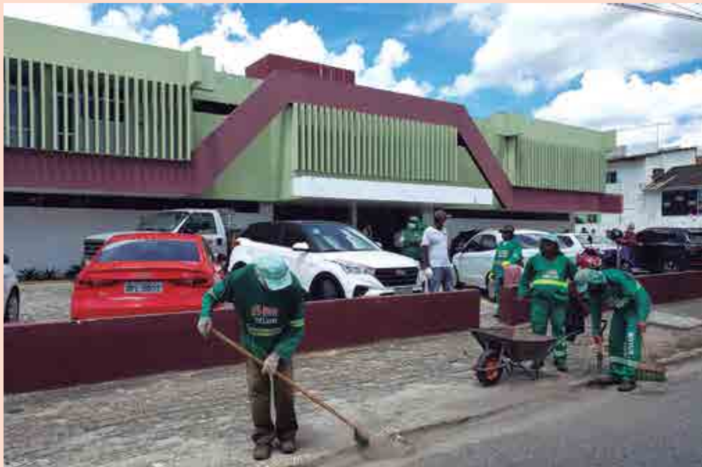
HTOP recebeu serviços de limpeza e higienização; além disso, a Cagepa e a Energisa já garantiram o fornecimento de água e energia do prédio
