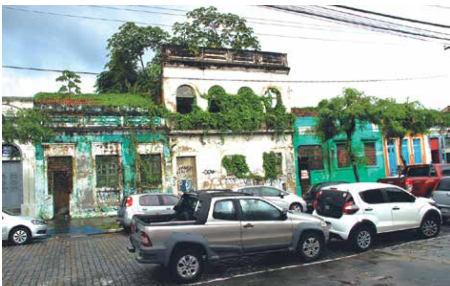
Muitas edificações possuem apenas as fachadas, já que todo o seu interior desabou
