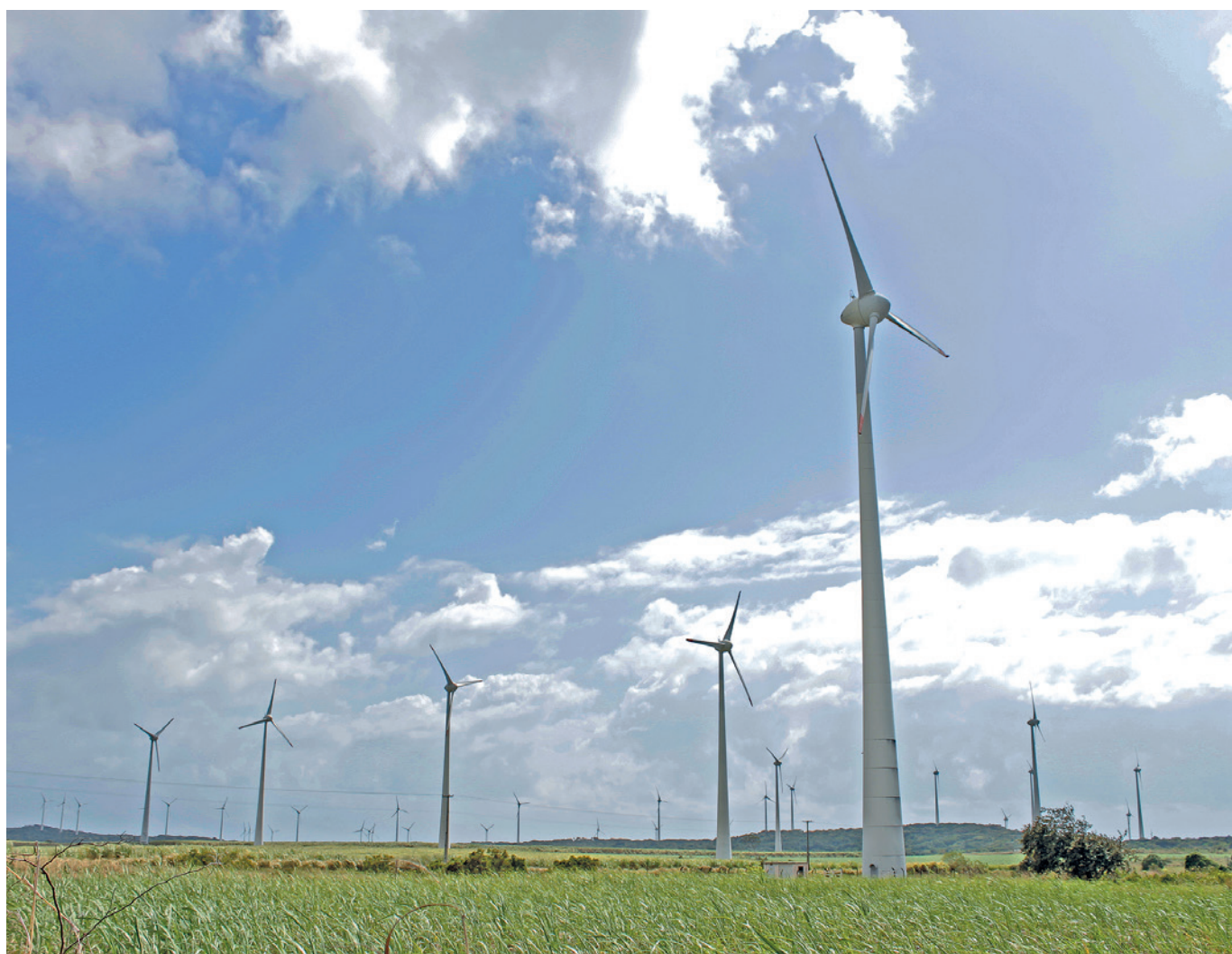
Parque Eólico Vale dos Ventos, no município de Mataraca, na região do Litoral Norte da Paraíba, é um dos destaques
