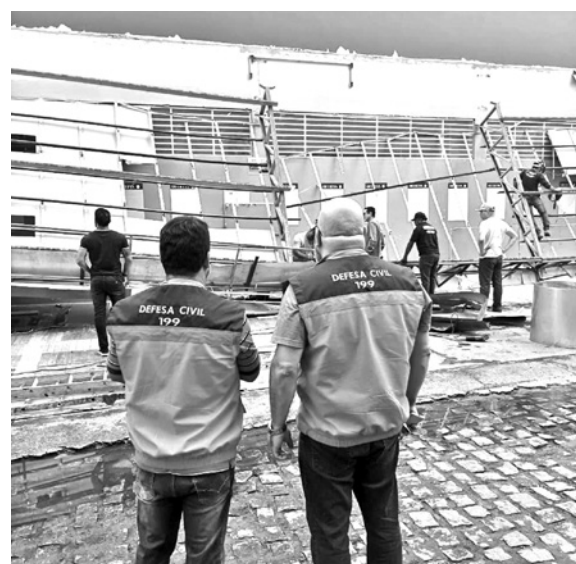
Técnicos da Defesa Civil fizeram uma vistoria no local
