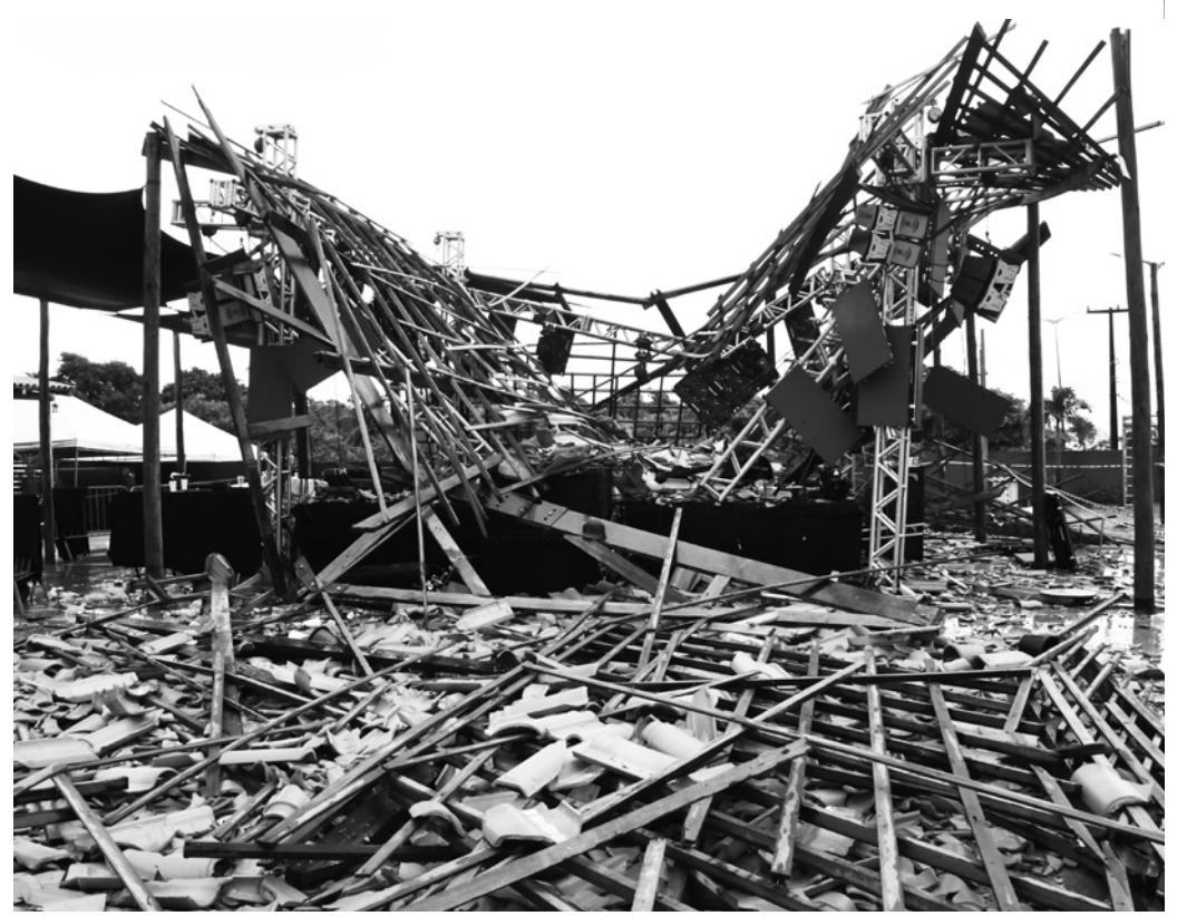
Telhado e grid metálico desabaram sobre artistas e parte do público, na noite do domingo
