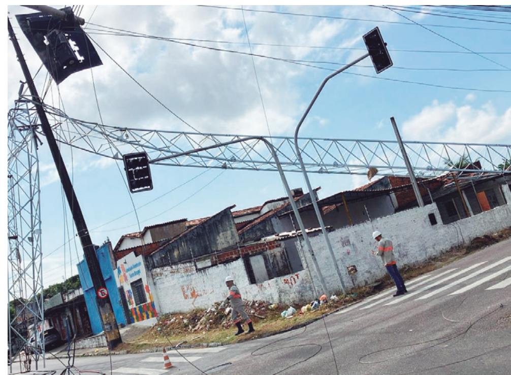
Incidente com estrutura da Brisanet, no bairro do Rangel, teria sido causado por vandalismo
