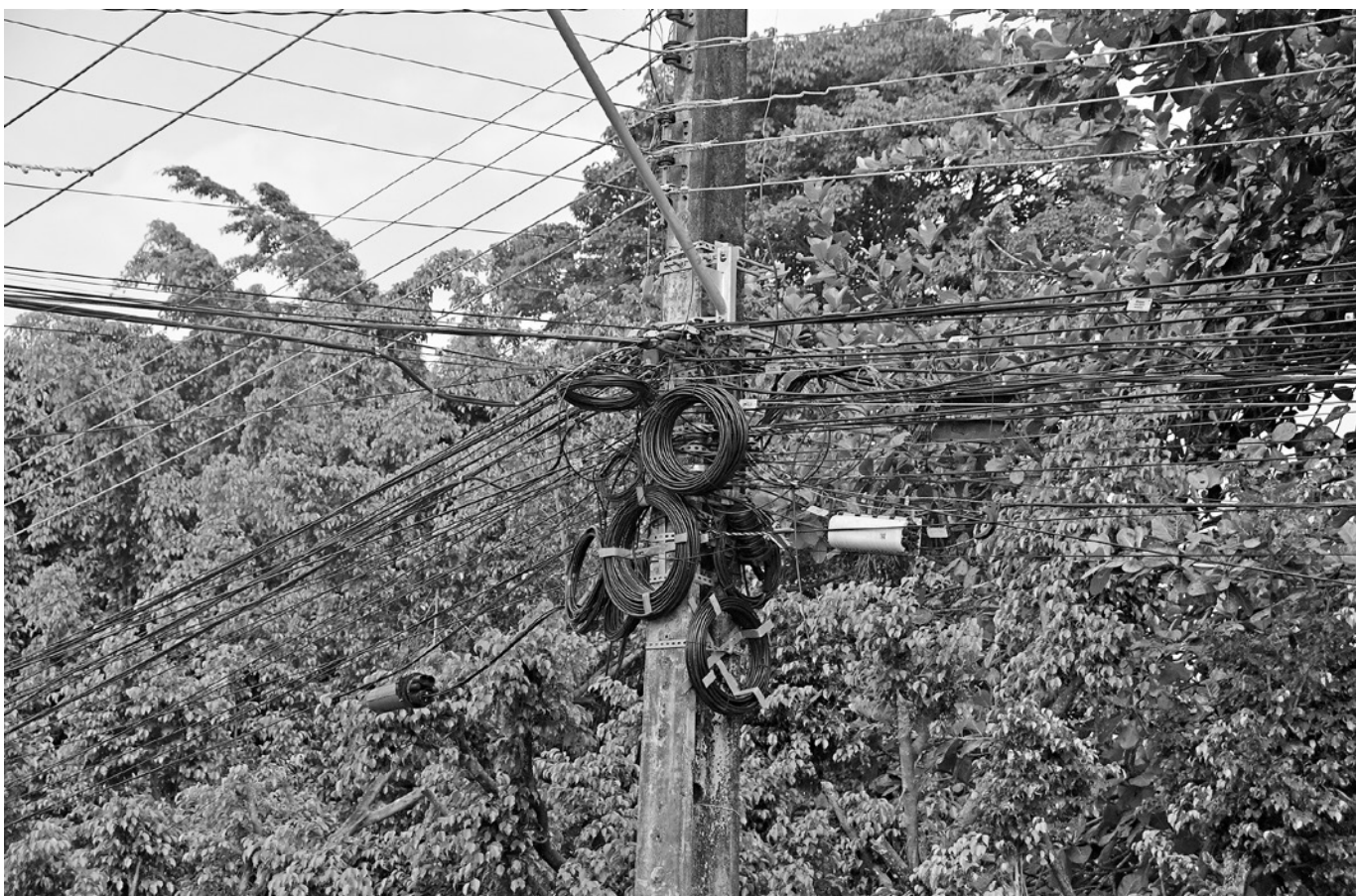
Suspensos sobre as calçadas, equipamentos de eletricidade e telecomunicações chamam atenção ao se acumularem
