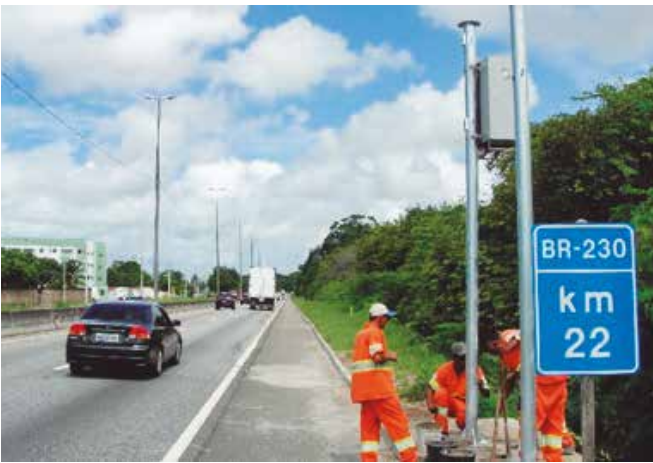
Deve-se instalar sinalização e barreiras de proteção no trecho
