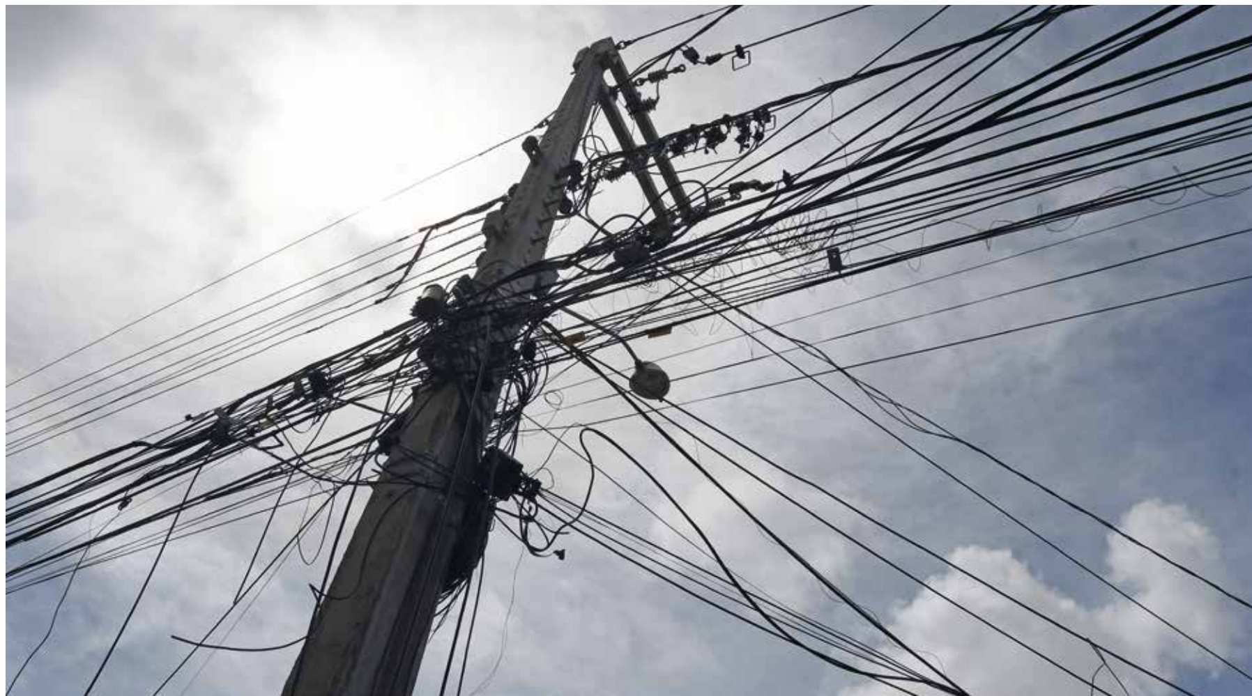
Excesso de fios compromete a estrutura dos postes, oferecendo risco aos cidadãos, além de prejudicar o serviço de energia e gerar poluição visual na cidade
