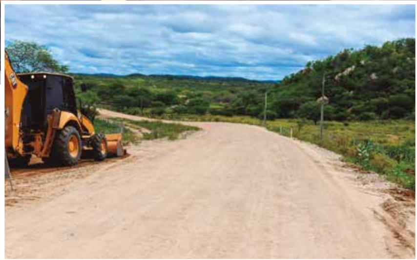
Durante a agenda administrativa, equipe do Governo do Estado ainda inspecionou projetos em andamento nos municípios de Sumé e Congo
