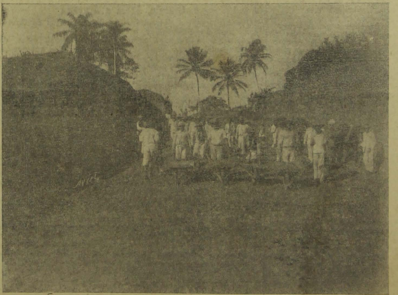
Photographia apanhada da estrada em construção João Pessôa-Goyana (Côrte n.º 2 — Transporte de terra por turmas de flagellados para o aterro em Umbuzeiro).
