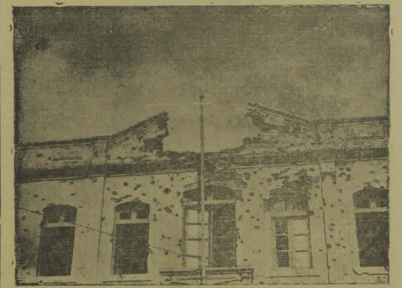
As condições em que se acha a fachada do Quartel de Policia, em Natal.
