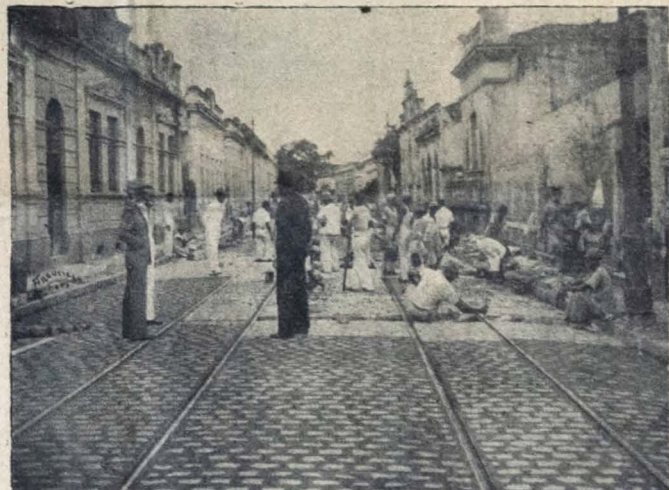
OS SERVIÇOS DE PAVIMENTAÇÃO DA CIDADE. — Desmas de operários trabalham, na rua das Trincheiras, na construção de um trecho de 6.100 metros quadrados de calçamento moderno. No clichê aparecem o secretário interino da Agricultura e o diretor de Viação e Obras Públicas, srs. Raul do Góis e Ovídio Pernambuco.
