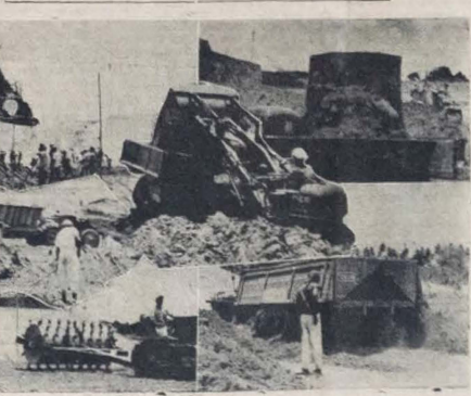
AS FOTOS acima foram tomadas durante uma fase de trabalho, em Mares, onde o Governo do Estado ultima as obras de fechamento do grande barragem. Os foguetes surgem numerosos tramas de trabalhadores empunhando nos referidos serviços, vestidos também, uma parte do material pesado empregado no acieiramento das obras do abastecimento da Capital, um problema que vem merecendo da administração acentuado interesse
