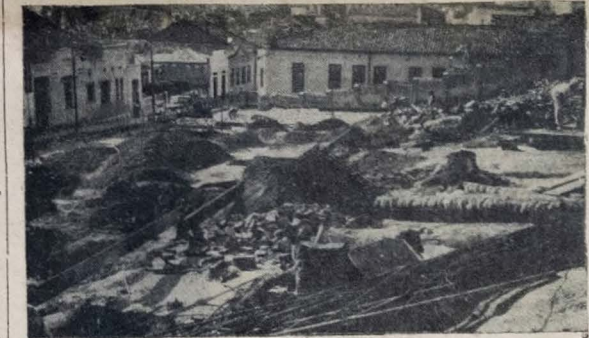
Um aspecto dos trabalhos de demolição do velho edifício da "Casa do Estudante", na Ladeira Feliciano Coelho
