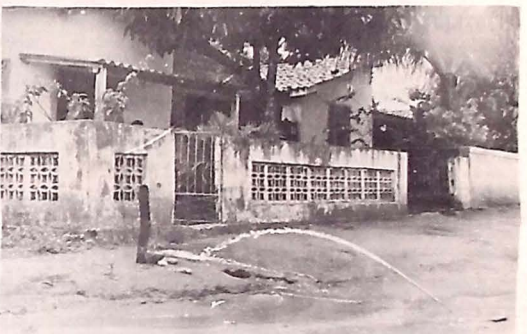
Um cano estourou na Rua da Fraternidade, localizada no Cristo, nas proximidades do Centro Espírita Mãe Naninha, foi a consequência de um trabalho de terraplanagem feito pela Prefeitura Municipal. Naquela Rua, este trabalho vem sendo realizado a cada duas semanas, e pela primeira vez aconteceu um acidente desta natureza. Os moradores solicitam providências imediatas da Cagepa, lembrando que há mais de uma semana convivem com o problema.
