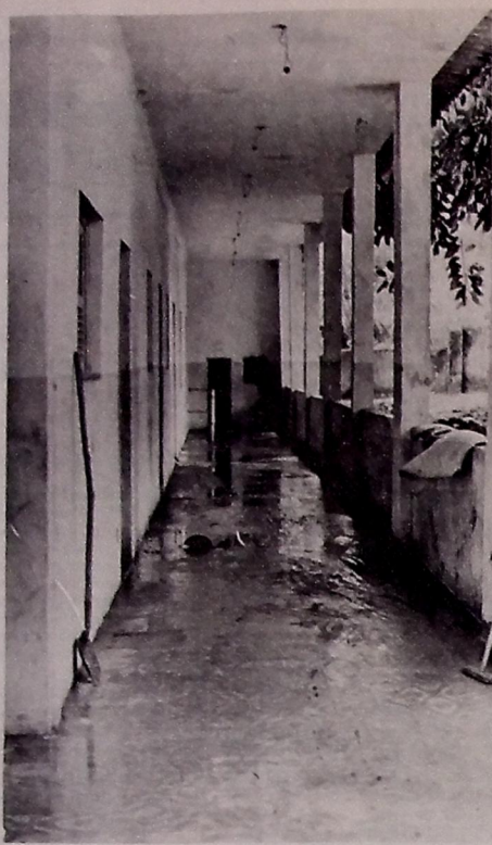
Aspecto da situação em que se encontra a Casa do Estudante
