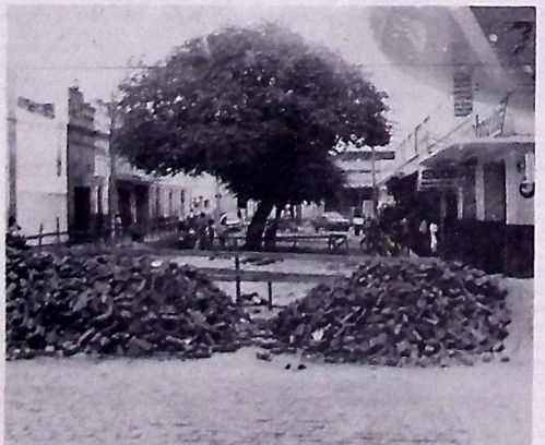
Sousa (A União) - O Calçadão, que está sendo construído pela Prefeitura Municipal de Sousa, deverá ser entregue dentro de aproximadamente trinta dias. Os trabalhos de construção estão em ritmo acelerado, e o Prefeito Sivalva Gonçalves Ribeiro acredita que cumprirá a promessa entregando a obra no prazo estipulado.
