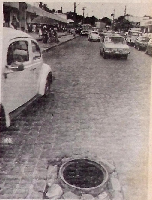
Com as saídas das galerias pluviais abertas tornou-se perigoso andar em algumas ruas da cidade. Na Pedro II, junto da parada de ônibus, esta galeria põe em risco carros e transeuntes enquanto não é colocado um sinal de advertência ao seu lado. Em outros pontos da Capital, os próprios transeuntes tentam resolver a situação, cercando as aberturas com galhos de árvores. Na maioria dos casos, as galerias continuam abertas.
