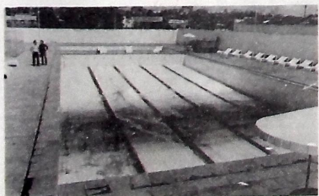
Os vazamentos no piso das piscinas serão obstruídos
